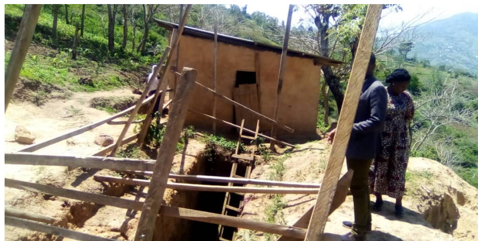
Aktueller Zustand des zu renovierenden WC Blocks und vorallem des Septischen Tanks.
